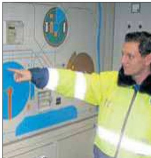
Die Schaltzentrale: Dennis Bobbert, Fachkraft für Abwassertechnik, erläutert den Weg des Schmutzwassers. Er ist zuständig für den Betrieb in Uschlag.
