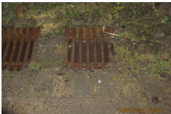
... das Wasser drückt schon in den Gullys der Sensensteinstraße.
